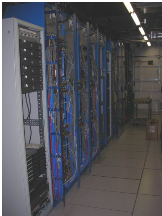
100m sous terre, quelques armoires informatiques traiteront les information de CMS avant de la envoyer à la grille
